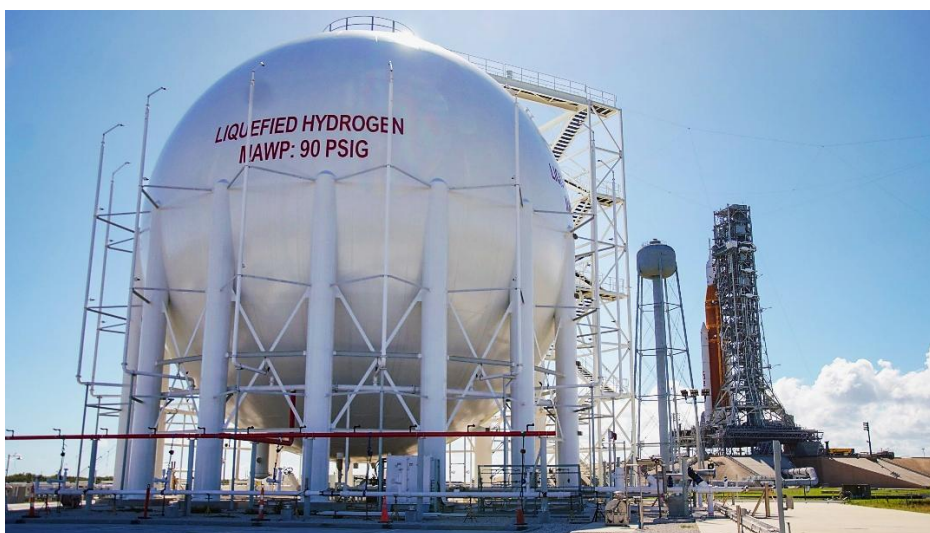
Figura 10: Maior esfera criogênica de hidrogênio líquido, situada no complexo de lançamento Kennedy Space Center da NASA
