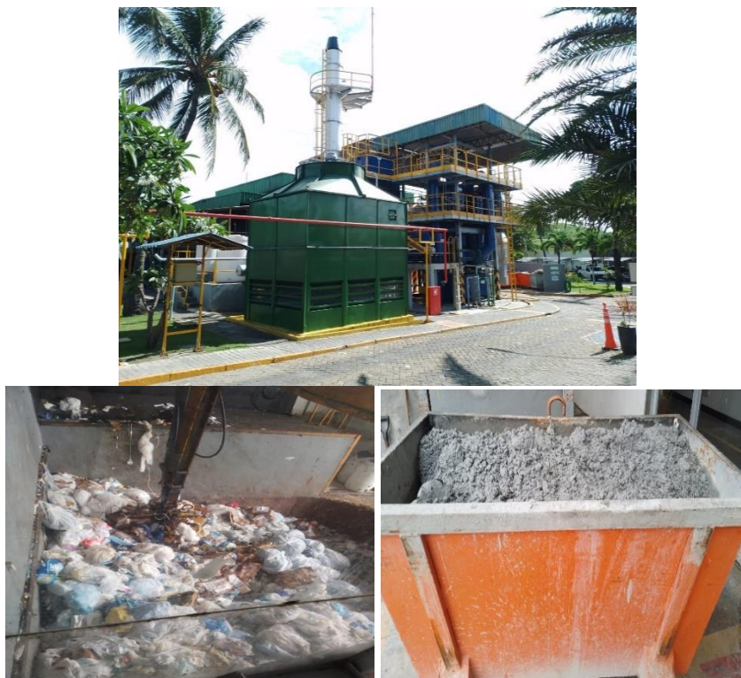
Figura 4 - Vista parcial do incinerador de Fortaleza, dos resíduos e cinzas
