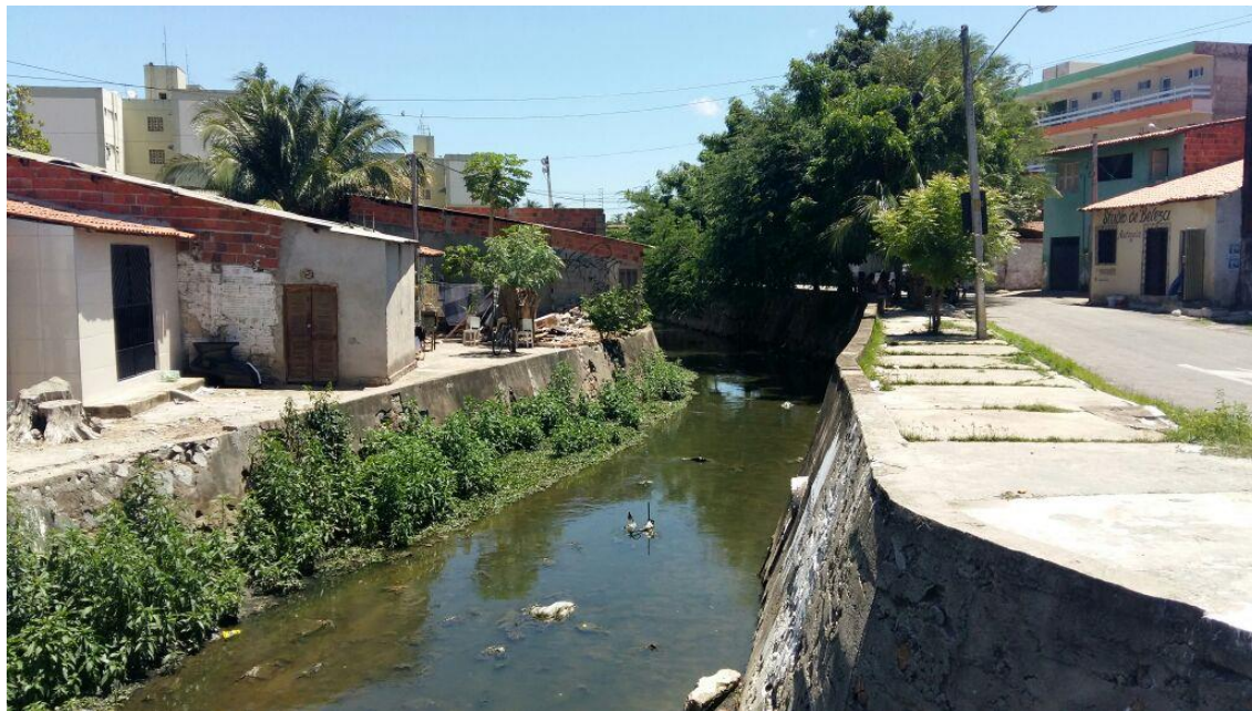
Figura 32- Foto do canal que alimenta o Santo Anastácio, mostrando as casas construídas irregularmente nas suas margens.
