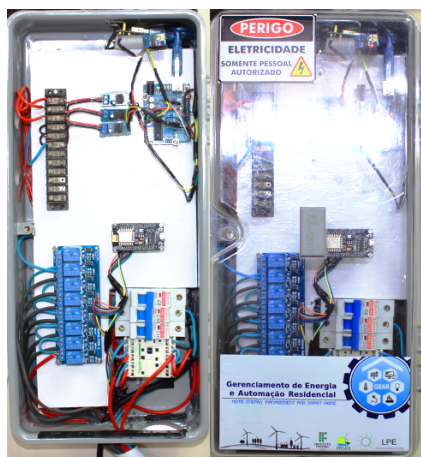
Figura 94 – Versão final do módulo de monitoramento da rede elétrica
