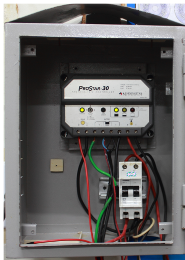
Figura 98 – Painel elétrico do controlador de carga do subsistema FV1
