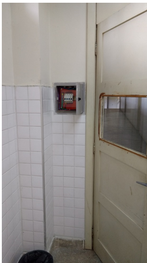
Figura 34 – Quadro de energia localizado dentro da sala de aula localizadas no final do corredor
