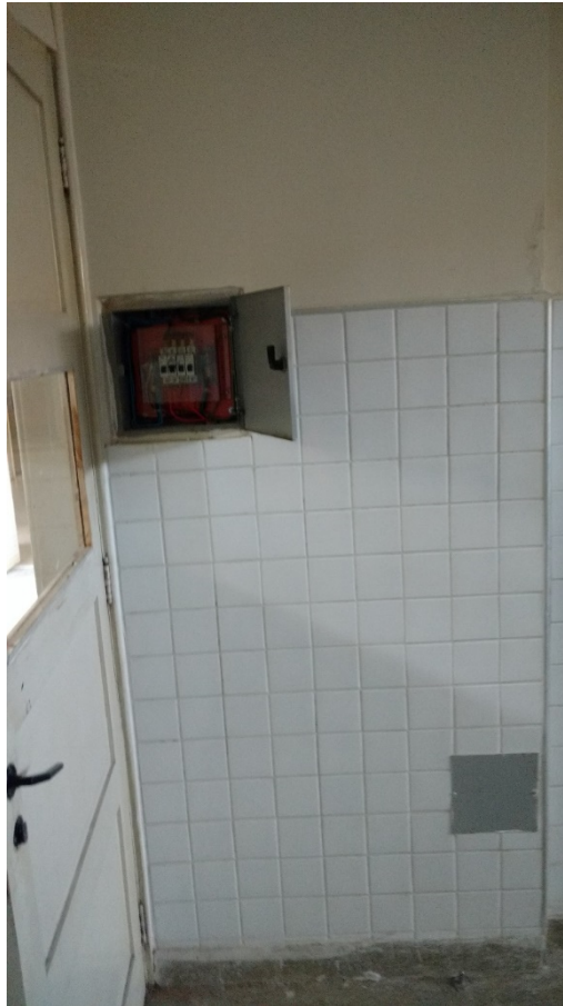
Figura 30 – Quadro de energia localizado dentro da sala de aula
