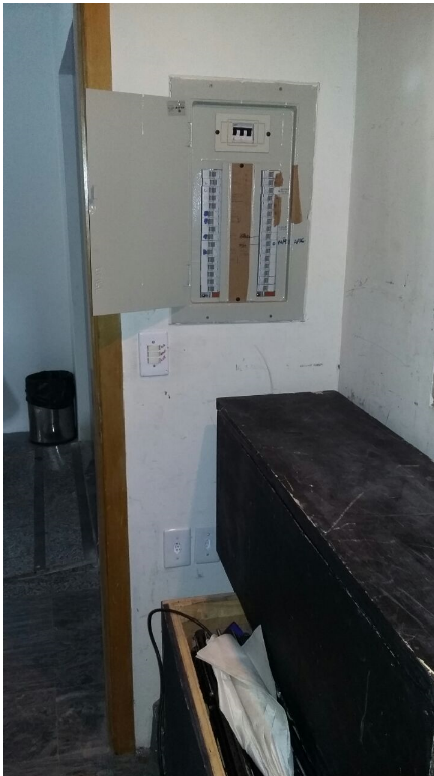
Figura 32 – Quadro de energia localizado dentro da sala de controle que alimenta condicionadores de ar no auditório
