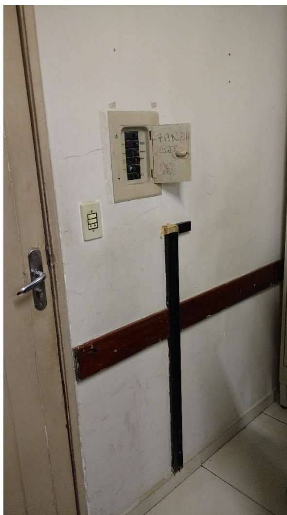
Figura 33 – Quadro de energia localizado dentro da sala da coordenadoria de tecnologia da informação
