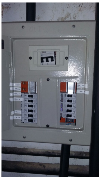
Figura 31 – Quadro de energia localizado dentro do shaft que alimenta condicionadores de ar nas salas de aula
