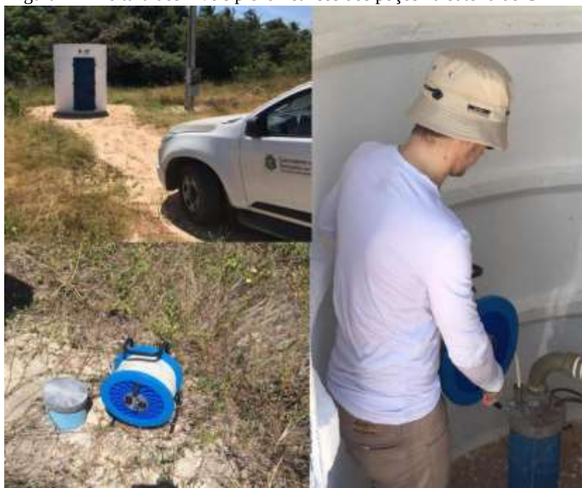
Figura 17 - Leitura dos níveis piezométricos dos poços na bateria do CIPP
