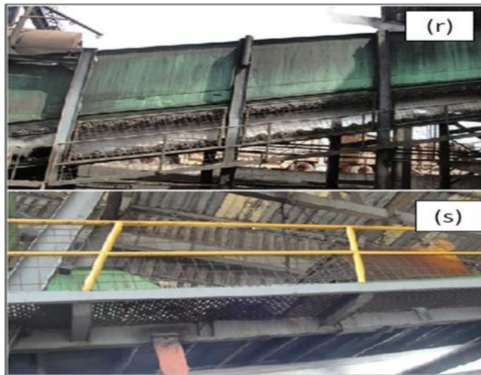
Figura 22 – Mesa alimentadora (r) e esteira de metálica (s).
