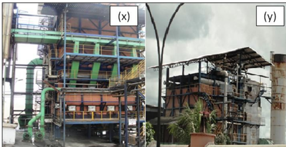
Figura 25 – Vista frontal da caldeira (x) e vista da chaminé da caldeira (y).
