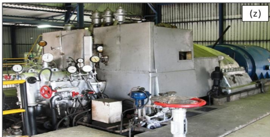
Figura 27 – Turbogenerador de condensação da usina Japungú.
