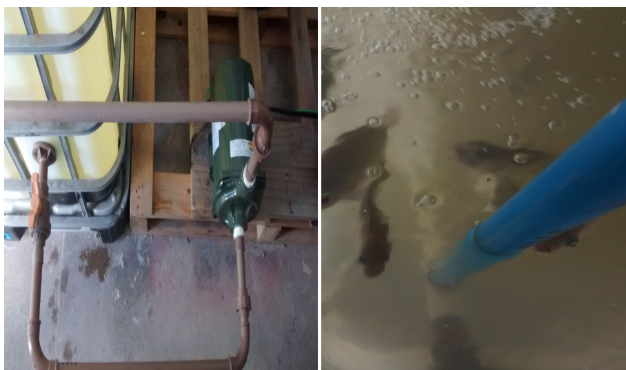
Figura 5: Sistema de aeração.
