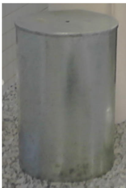
Figura 21 – Gasômetro do biodigestor.
