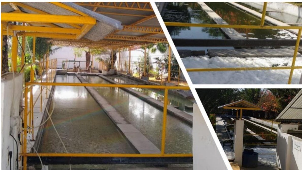
Figura 4 - Vistas parciais da ETE da CTRP
