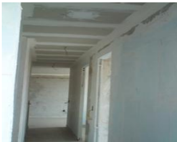
Figura 12 - Forro com placas de gesso observado em obra visitada em 2012.
