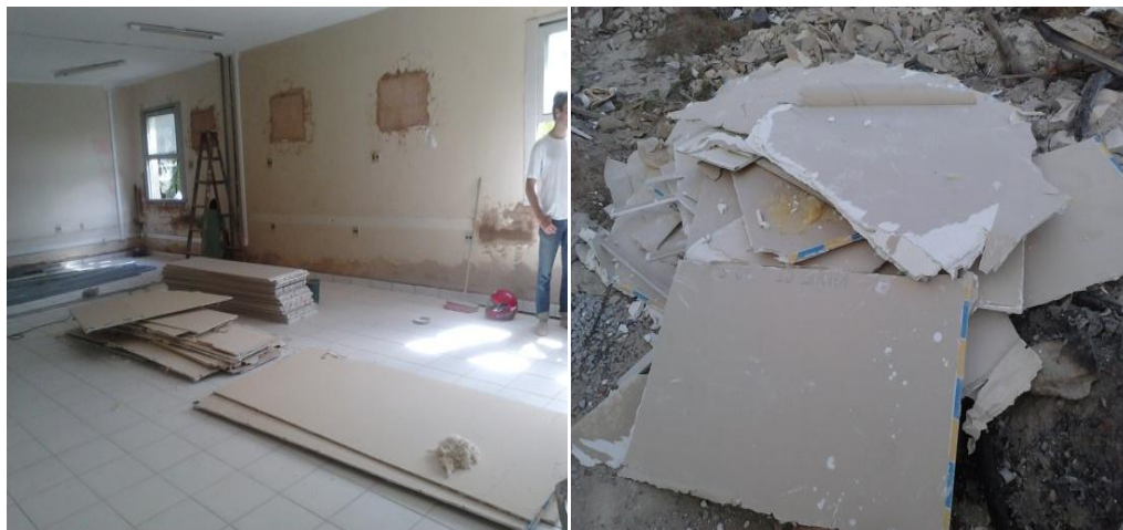
Figura 19 – Resíduos gerados durante a execução das divisórias de gesso drywall .
