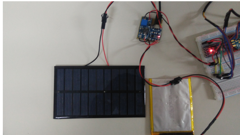
Figura 19: Módulo de suprimento de energia.
