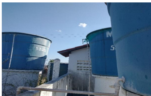
Figura 10 — Reservatórios para água bruta, água doce e água do concentrado
