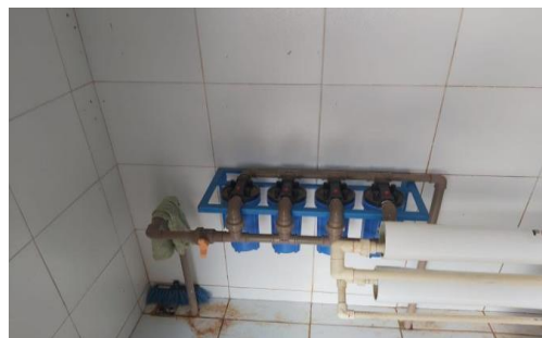
Figura 9 — Conjunto de filtros do pré-tratamento do dessalinizador
