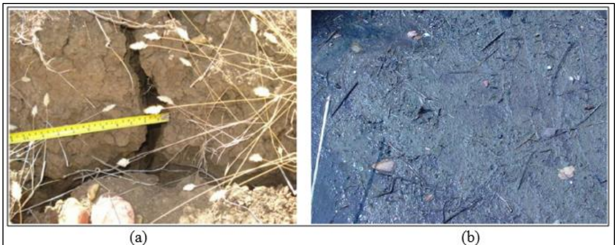
Figura 12 — (a) Estrutura do solo no período seco; (b) Encharcamento do solo no período chuvoso.
