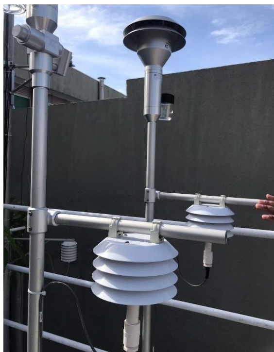
Figuras 9 – Equipamentos da estação para monitoramento de poluentes atmosféricos.
