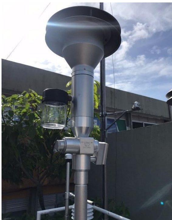
Figura 8 – Equipamentos da estação para monitoramento de poluentes atmosféricos.
