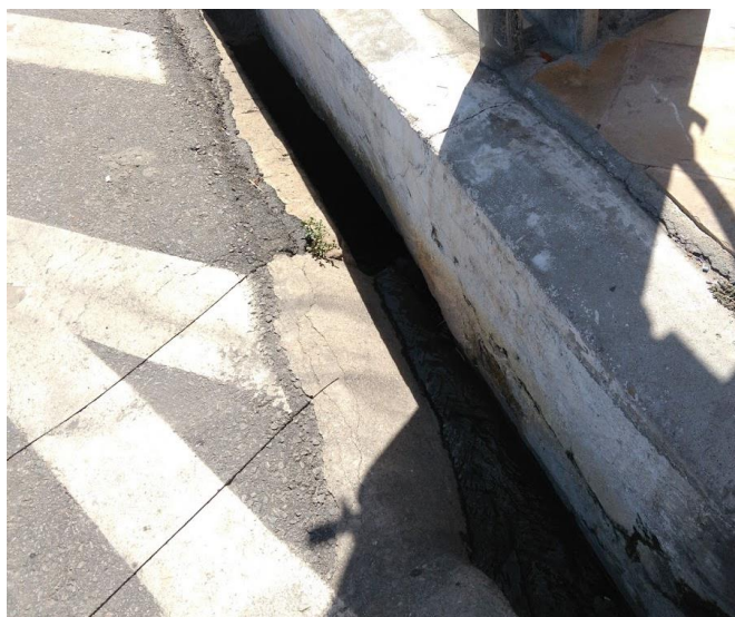
Figura 23 - Lançamento de efluente de drenagem urbana, Avenida Beira Mar.
