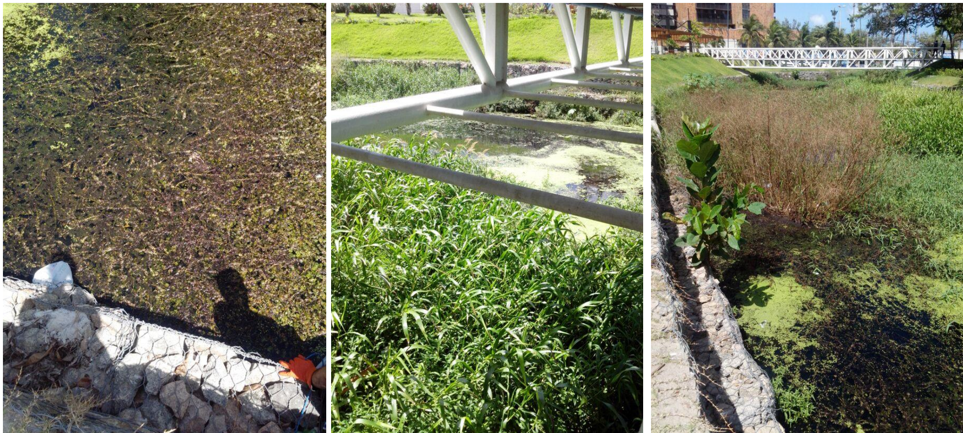
Crescimento excessivo de plantas e macrófitas – Foz do Riacho Maceió, Fortaleza-CE.
