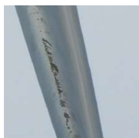
(c) Dano de erosão classificado corretamente
