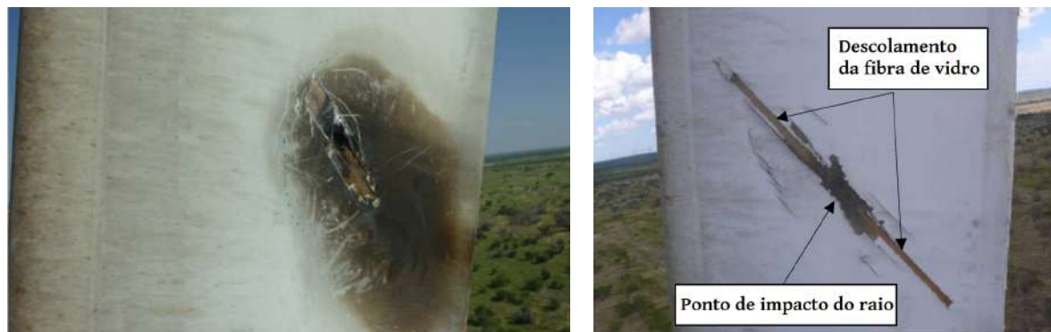
Figura 6 – Exemplos de danos por descargas atmosféricas
