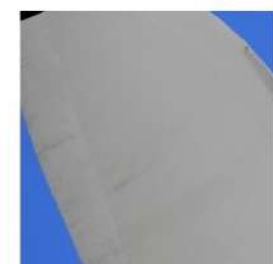
(e) Dano de pintura classificado corretamente
