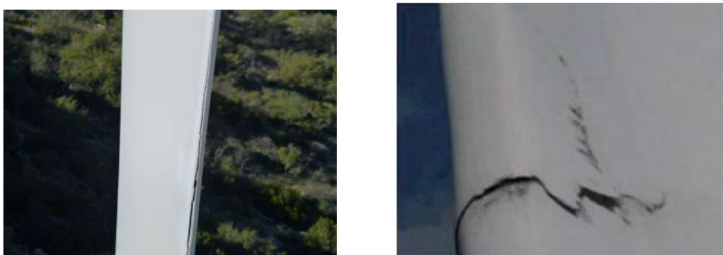
Figura 9 – Exemplos de danos de trincas
