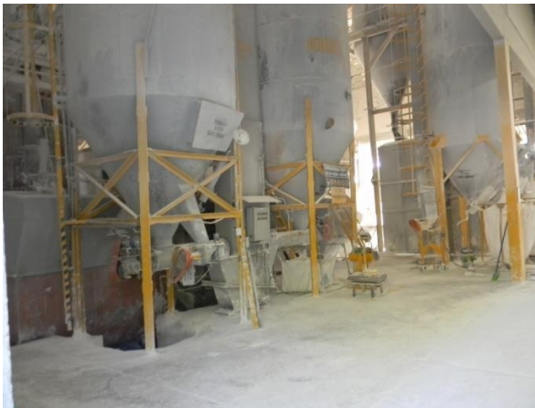
Figura 7 – Fotografia dos silos de estabilização, usina de fabricação de gesso, em Santana do Cariri/CE
