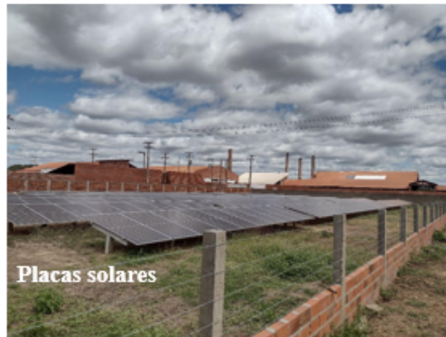
Figura 12 — Placas fotovoltaicas para fornecimento de energia solar na indústria
