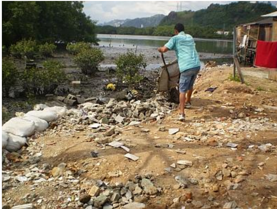
Figura 4 - Aterramento irregular de lagoa para construção de moradia em Santos-SP. Fonte: Instituto EcoFaxina, 2011.
