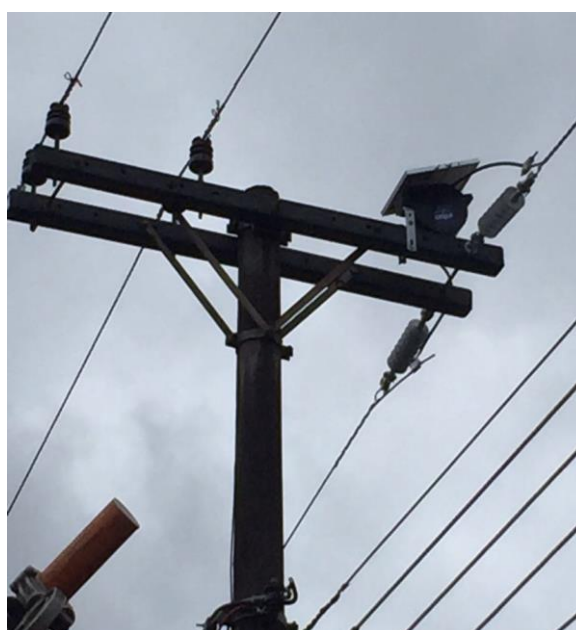
Figura 4-15 Sensor instalado na linha de 13,8 kV
