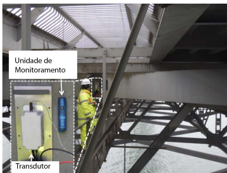
Figura 7 – Sensor instalado na ponte Forth Road. Adaptado de (JIA et al., 2015).
