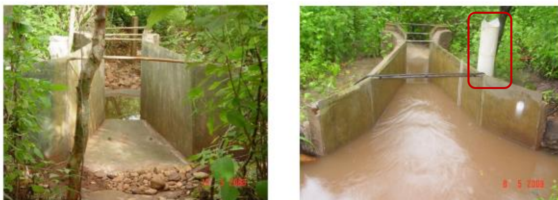
Figura 5 - Calha Parshall instalada em capo e poço tranquilizador para linígrafo.
