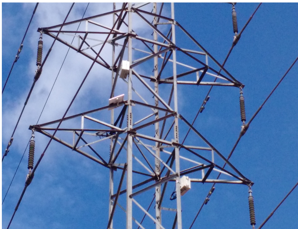
Figura B.5: Sensor instalado em uma das torres da linha de transmissão da eletroAcre.
