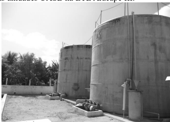
Figura 17 – Fotografia das unidades UASB na ETE Aracapé III.
