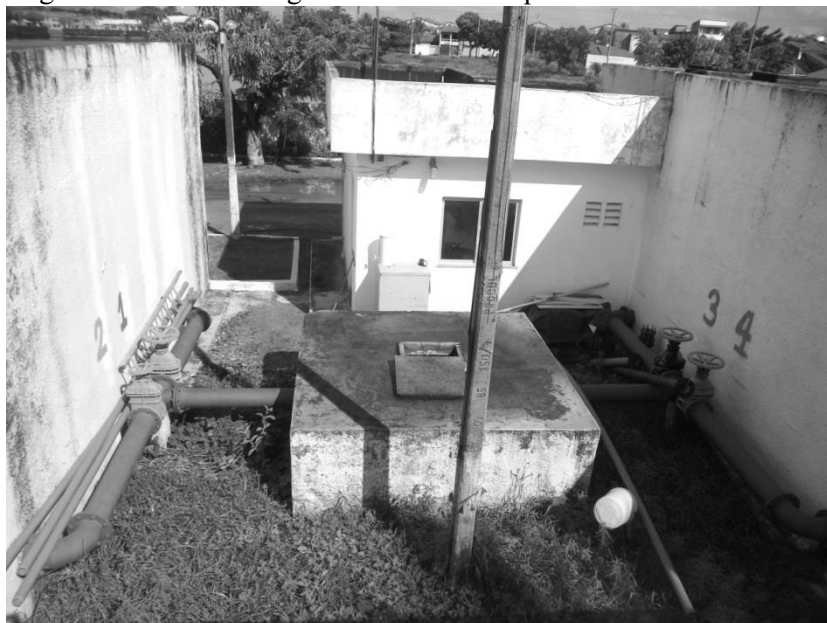
Figura 20 – Fotografia dos decanto-digestores da ETE Pequeno Mondubim.
