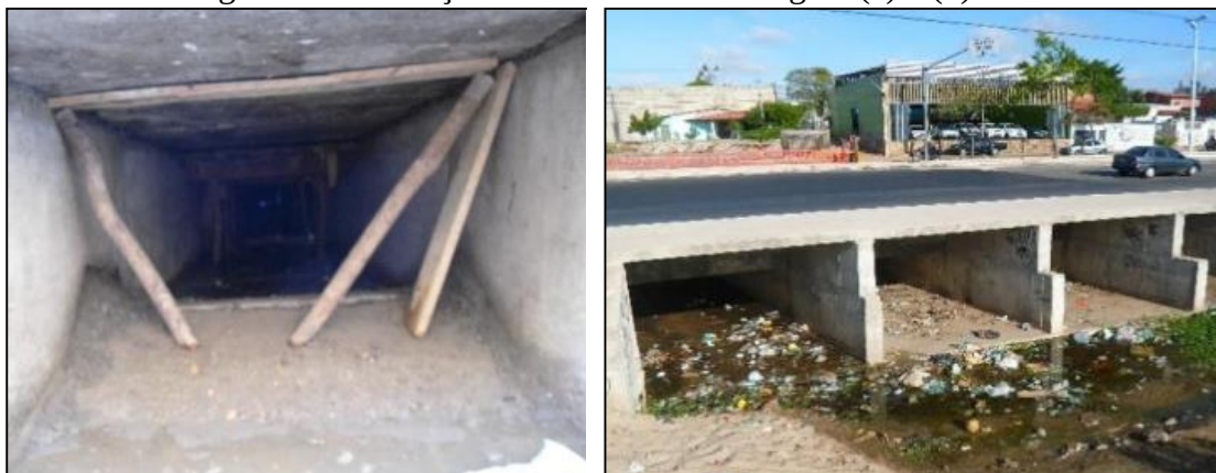
(a) Interferência de redes externas nas galerias de drenagem
